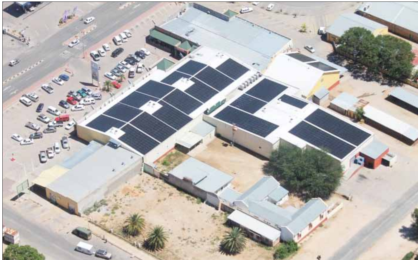
Die Luftaufnahme zeigt die 250kWp-Solaranlage auf dem Dach von Theos Superspar in Otjiwarongo.
