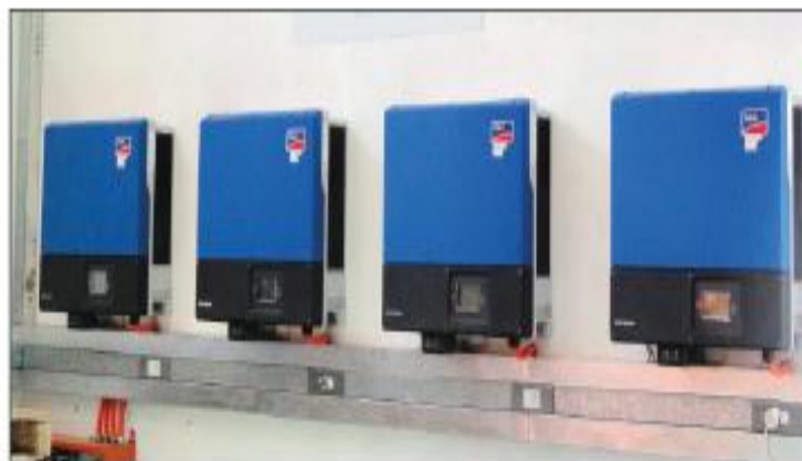
Wechselrichter, die den Gleichstrom der Solaranlage in nutzbaren Wechselstrom umwandeln. HopSol setzt dabei Wechselrichter des deutschen Weltmarktführers SMA ein.
